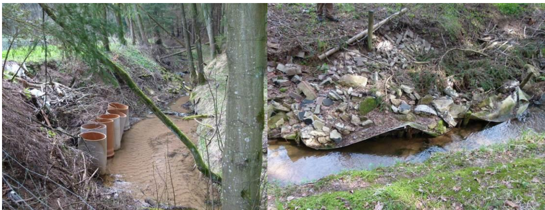
Abbildung 17: Ufersicherung am Röthenbach
